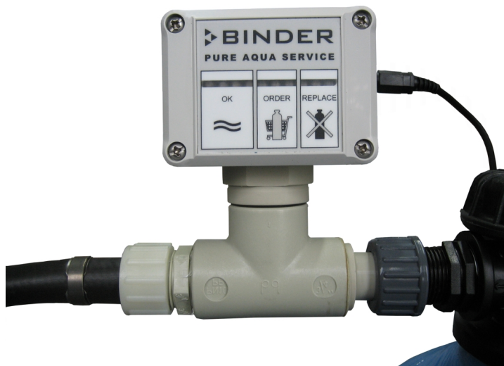
Fig. 8: L'équipement de mesure connecté à la cartouche et au bloc d'alimentation avec le tuyau d'eau traitée
